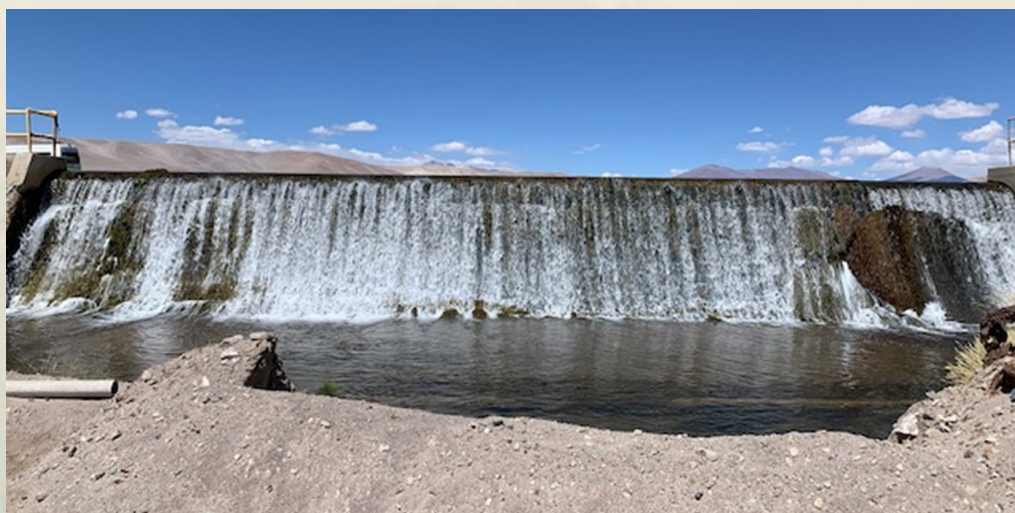
FIGURA 5. REBOSE DE AGUA EN MURO TRANQUE LA OLA
